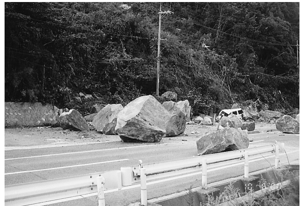
写真 6 鳥取県主要地方道日野溝口線 落石状況
