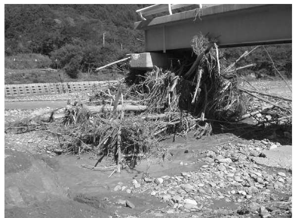
写真 2 落橋したアブシ橋の橋脚周辺の流木
