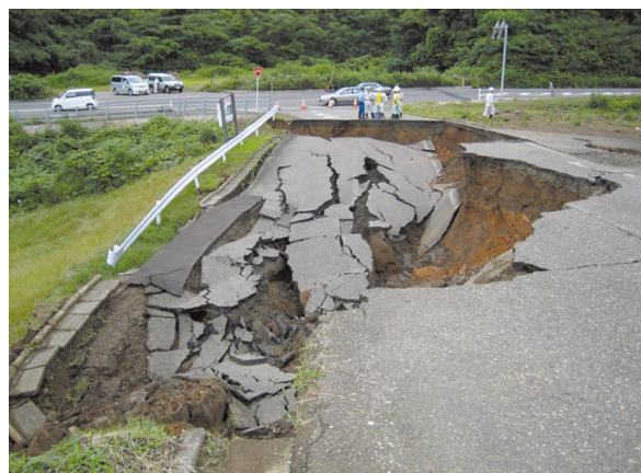
写真－2 地震で寸断された道路 (新潟県中越沖地震)
