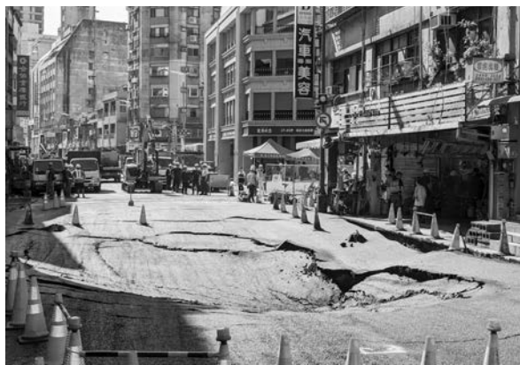
写真－4 大同区南京西路で発生した陥没事故
