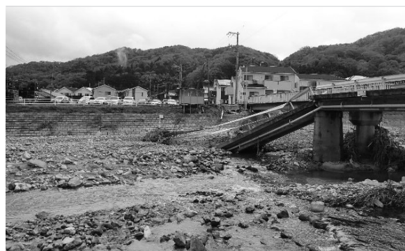
写真－1 橋梁被災状況（一貫田橋，瀬野川）
