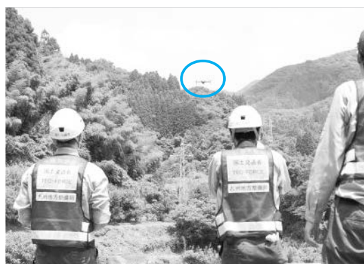
写真－6 ドローンによる被災状況調査（熊本県甲佐町）
