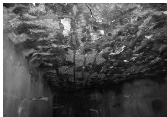
写真－8 塩害で劣化した橋脚フーチング
