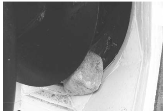
写真-9 転石状況 (2)
