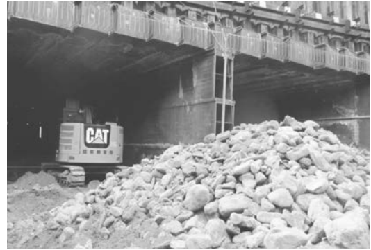
写真-8 転石状況 (1)
