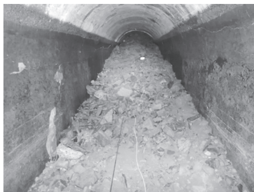
写真－1 導水路 落盤部の崩壊状況
