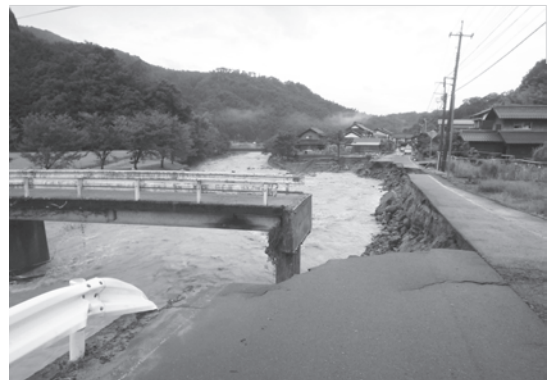
写真-2 私都川の氾濫による被災状況
