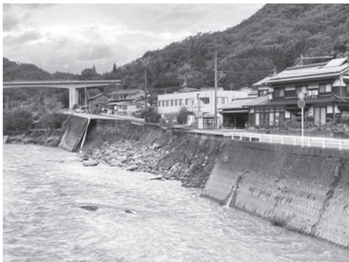
写真-1 佐治川の氾濫による被災状況
