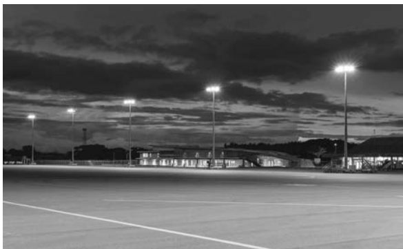
写真－7 電動昇降式のLEDエプロン照明
