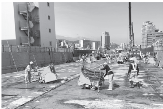
写真－1 コンクリート床版の主桁位置に拘束されない全断面切断の様子
