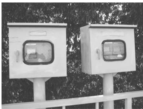
写真-5 試験に使用した配電盤
