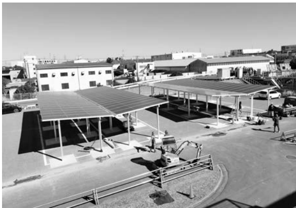
写真-2 南部浄化センター 太陽光発電設備（カーポート型）
