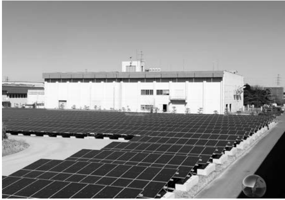
写真-1 南部浄化センター 太陽光発電設備
