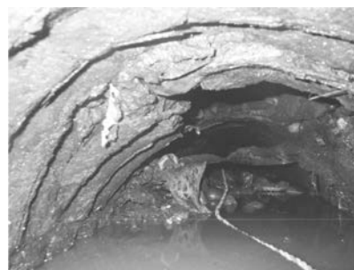
写真-3 腐食した鋼製コルゲート管の状況
