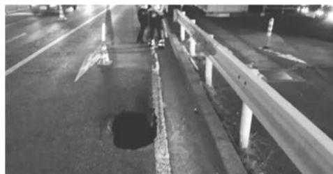
写真-2 道路陥没の発生状況
