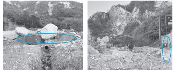
左：9月豪雨による上流からの落石（国道249号曾々木海岸） 右：国道249号を越えた落石
