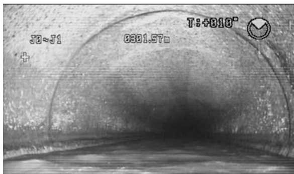
写真-8 調査事例2：船体式テレビカメラ調査の様子と確認した異状箇所（管路内面の腐食あり）
