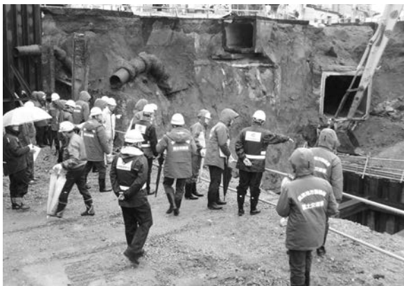
写真-5 八潮市陥没現場の視察の様子
