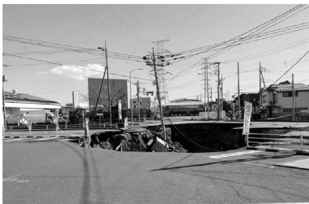
写真-1 1月30日 陥没拡大後の写真
