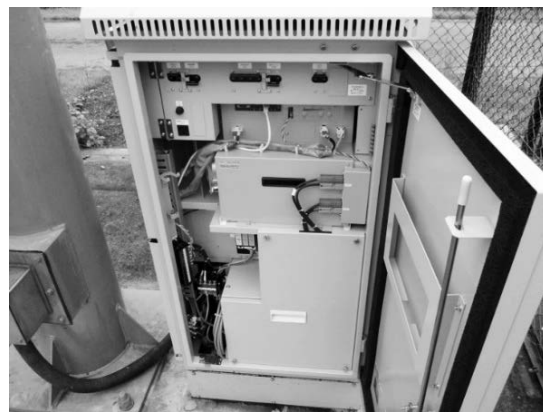
写真－1 屋外用無停電電源装置
