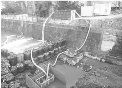
写真－19 ポンプ運転状況
