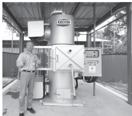
写真－7 小型焼却炉 STH 型を病院に設置
