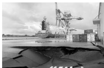
写真－9 液状化による舗装陥没（金沢港）
