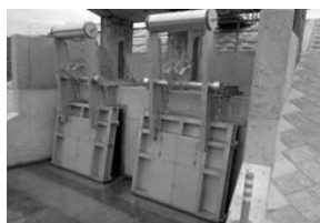
写真－10 樋門の無動力化
