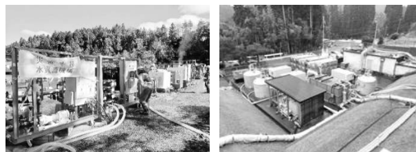
写真-5 可搬式浄水施設の稼働状況
