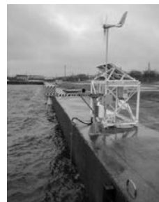
写真－11 機動型津波観測施設の設置例
