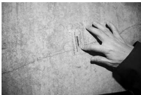
写真－5 現場におけるひび割れ幅の検証作業 （筆者と現地コンサルタント会社の技術者）
