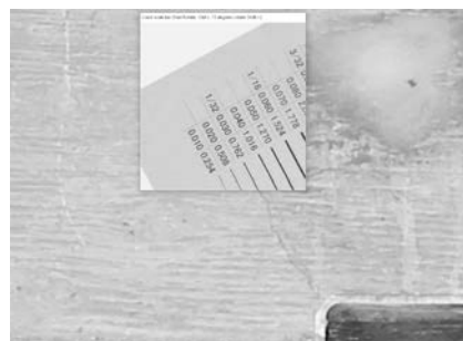
写真－4 画像上に表示したバーチャル・クラックスケール
