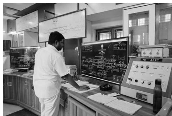
写真-1 南鉄道局 テニ駅 制御盤
