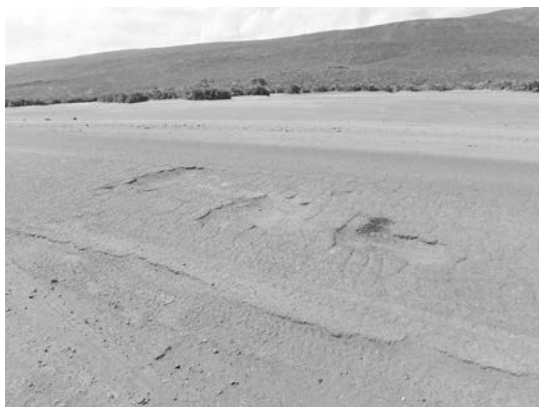
写真－2 ジブチ国 損傷した既存道路
