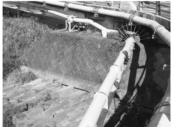
写真-2 橋梁下の護岸基礎沈下
