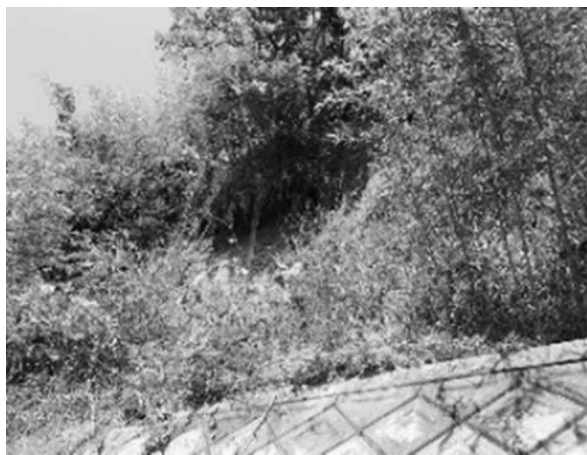
写真-1 法面の崩れ現地写真
