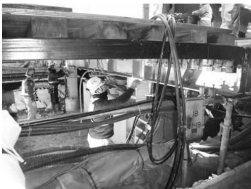
写真-3 連動式ジャッキを使用したホーム低下（ホーム下の状況）
