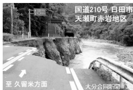
写真－4 国道210号での被災状況
