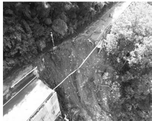
写真-1 ドローンによる災害状況の撮影（令和4年台風14号）
