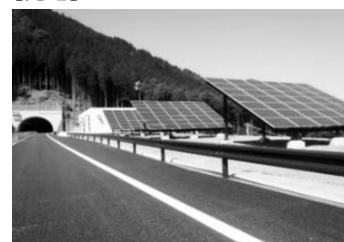
道路空間の太陽光発電設備
