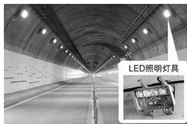
道路照明のLED化
