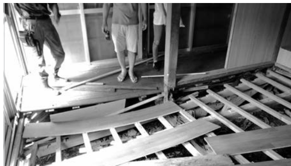
写真-1 修繕が必要な空き家の内部
