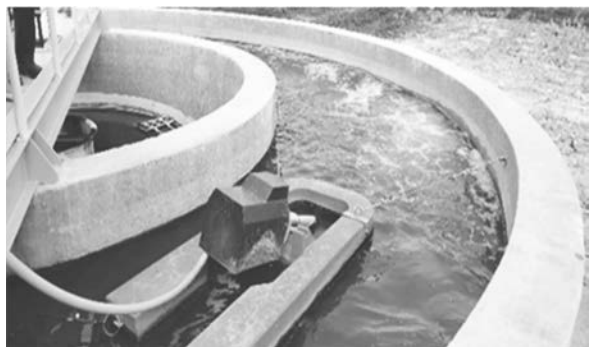
写真-3 POD コンセプト実証施設
