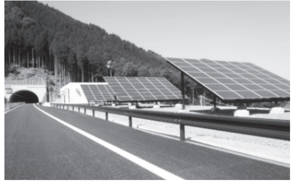
写真-5 道路における太陽光発電設備の設置事例
