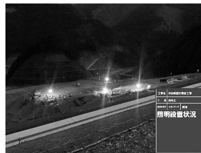
写真－8 照明設備
