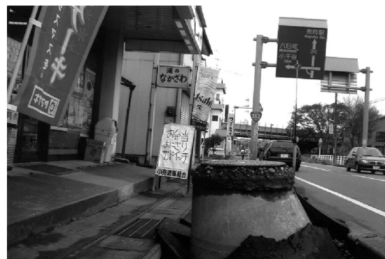
写真 3 マンホールの浮き上がり（長岡市長倉町）
