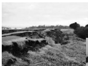
裏法崩れ状況 (10月24日)
