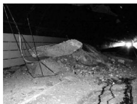
コンクリートが剥離 (10月24日)
