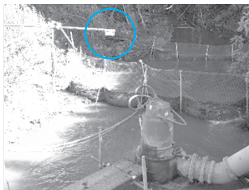
写真-3 水位計設置状況
