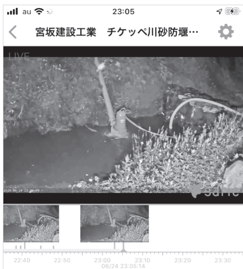
写真-6 スマートフォンによる夜間遠隔監視
