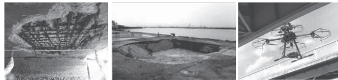
内部の鉄筋が露出した橋梁 陥没した港湾施設のエプロン部分 カメラを搭載したドローンによる点検
