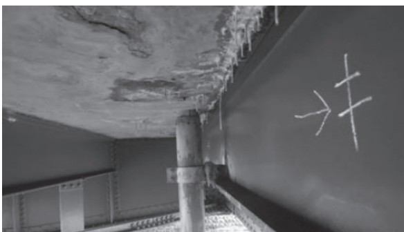
写真-4 床版のひび割れ
