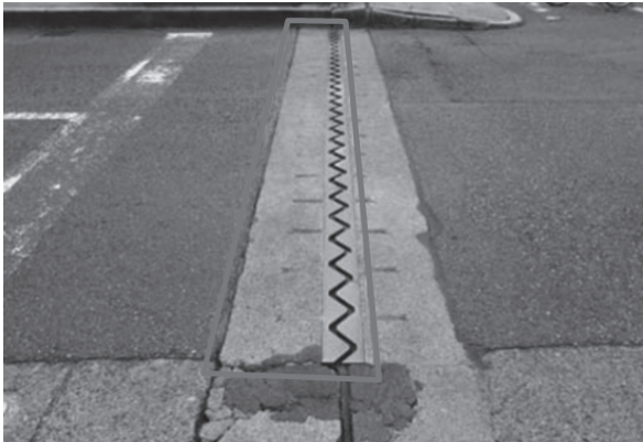
写真-2 伸縮装置の損傷
