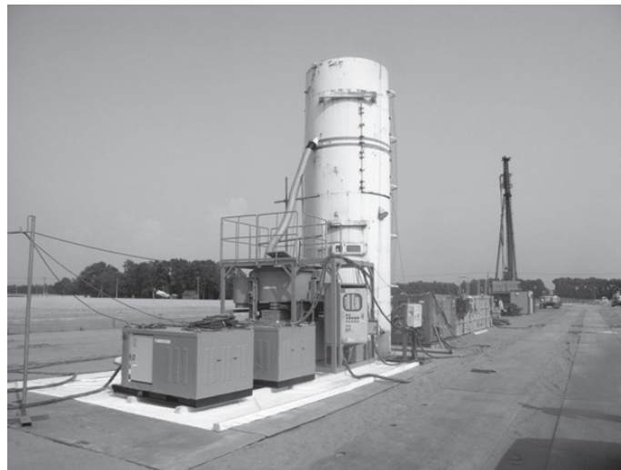
写真-2 スラリプラント
