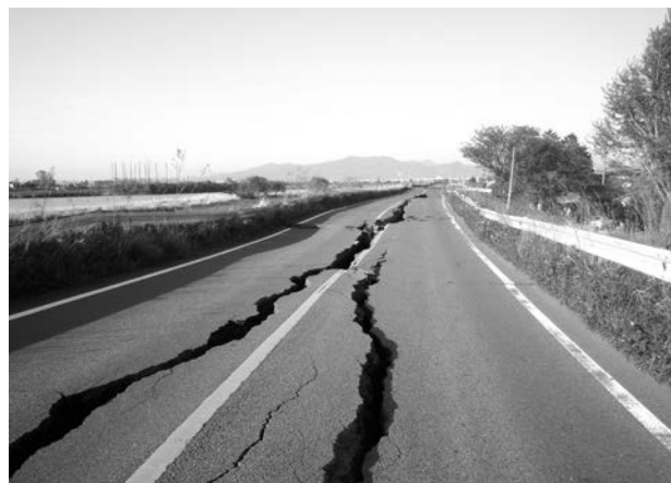
写真-2 堤防（兼用道路）天端の亀裂
