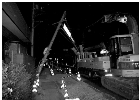
写真 4 架空線等損傷事故
