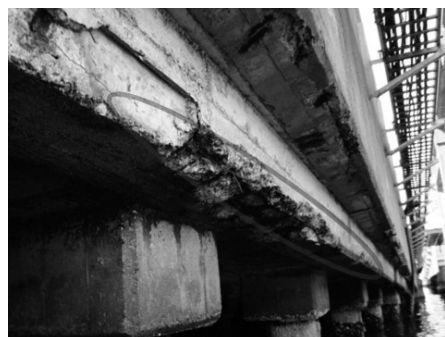
写真—1 東品川栈橋損傷状況
