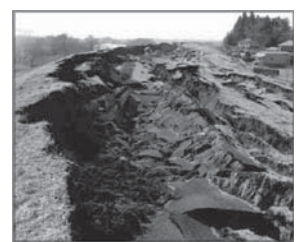
堤防が大規模沈下した鳴瀬川上流部（宮城県大崎市下中ノ目地先）
