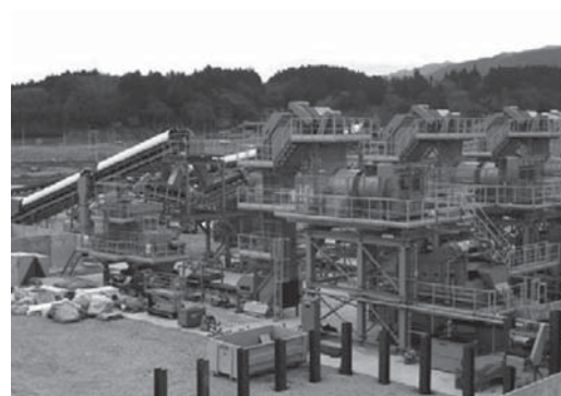
(f)仮設の津波堆積物処理施設 (平成25年4月岩手県陸前高田市)
