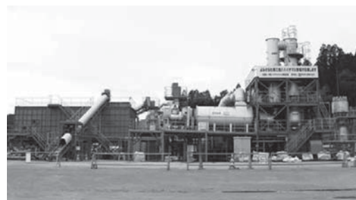
(b)仮設バイオマス発電システム (平成25年11月宮城県南三陸町)
