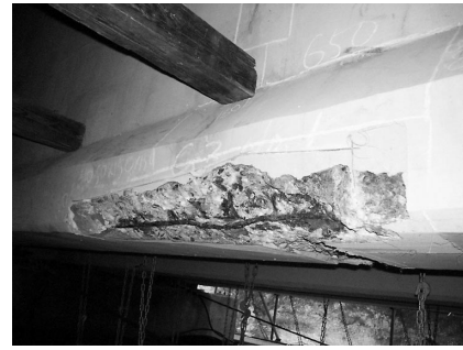
写真 1 鉄筋腐食によるコンクリートの剥落
