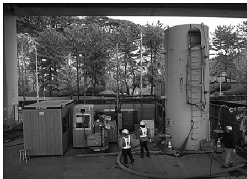
写真三 スラリプラント設置状況
