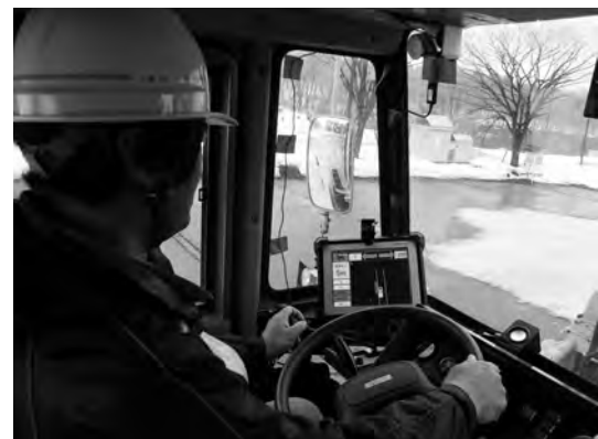
写真一3 装置を見ながらの運転
