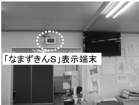
写真 11 「なまずきんS」現場設置状況
