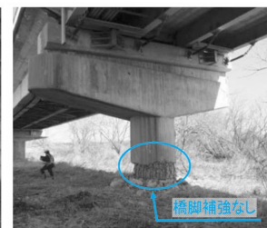
【耐震補強なし】 橋脚が地震動により損傷
